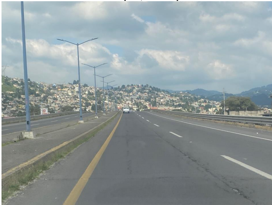
Imagen 29. Estado de la carretera Toluca-Naucaipan a la altura del poblado de Santa María Zolotepec, Municipio de Xonacatlán.
